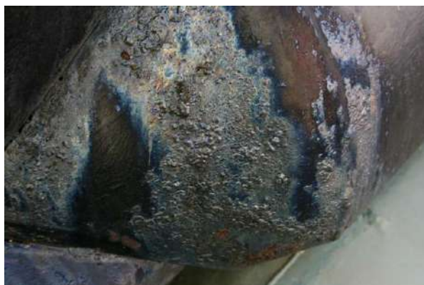
Fig. 5. Développement de la corrosion sous le film de peinture. NUM20080476
