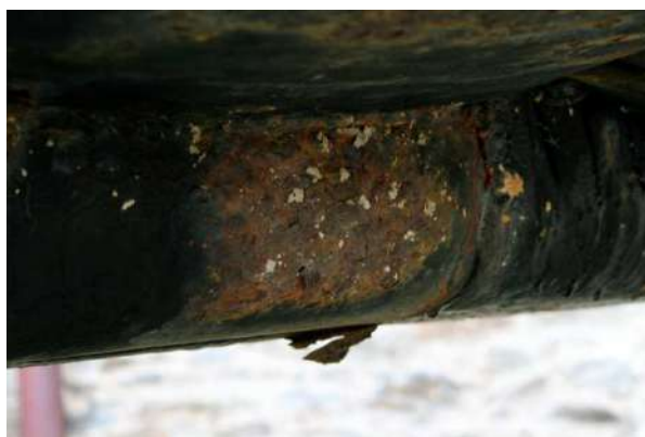
Fig.4. Zone fortement corrodée relevée sous la barre de plongée de gauche à l'arrière du navire. NUM20080475
