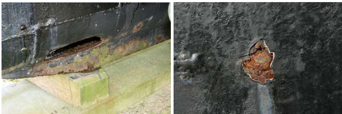
Fig.2 et 3. Phénomènes de corrosion observés (photo de gauche - NUM20080473) à l'arrière du bâtiment au niveau de la quille et (photo de droite - NUM20080474) à l'avant sur le flanc gauche du navire.
