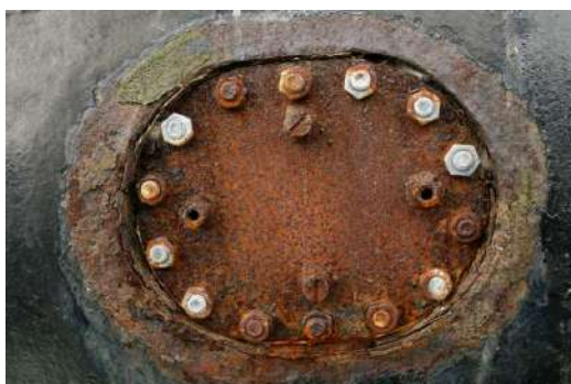
Fig. 21. Vue externe de la trappe arrière. (NUM20080471)
