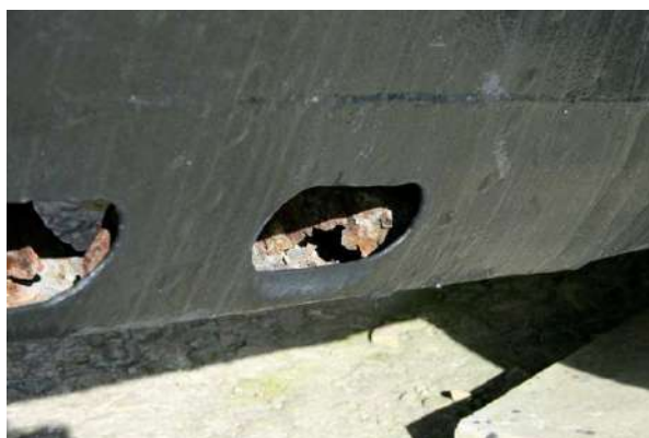
Fig.6. Tôles corrodées dans des zones de rétention d'eau (partie avant basse de la coque) (NUM20080458)
